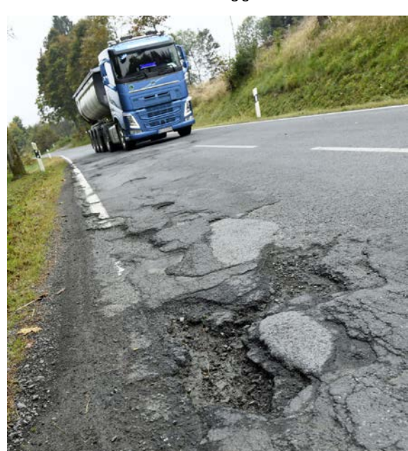
Stellenweise sehr kaputt ist die Straße von Sonneberg nach Spechtsbrunn. In absehbarer Zeit will hier das Thüringer Landesamt für Bau und Verkehr (TLBV) Abhilfe schaffen.
